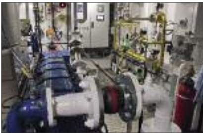
Ein Erdgasmotor auf der RoPax-Fähre MS „Ostfriesland“ mit Erdgaszufuhr, so genannter Gasregelstrecke. Foto: P. Pospiech
