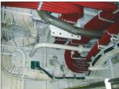
Verbindungsleitungen verschiedener Systeme
